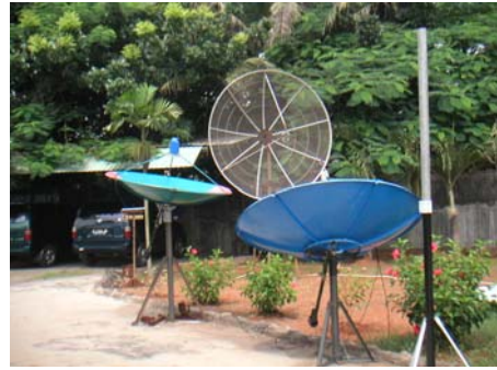
印尼 SS 工厂门前的天线
